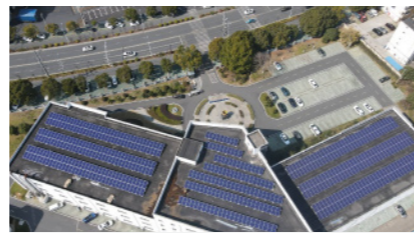
中鼎密封件光伏项目（一期）
