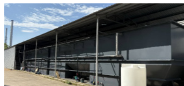
80T/D综合污水处理站
