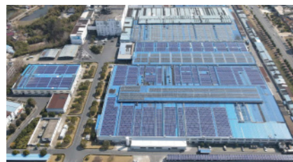
中鼎密封件光伏项目（一期）
